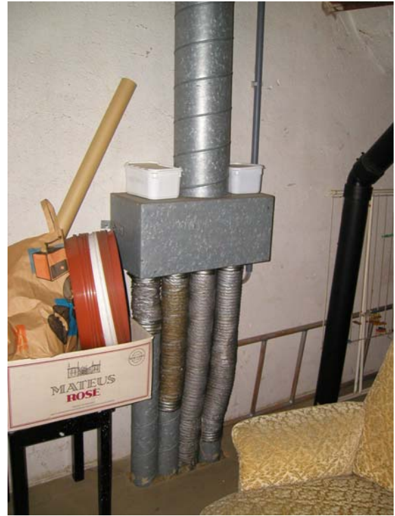
Abluftkanäle der gefangenen Nasszellen
